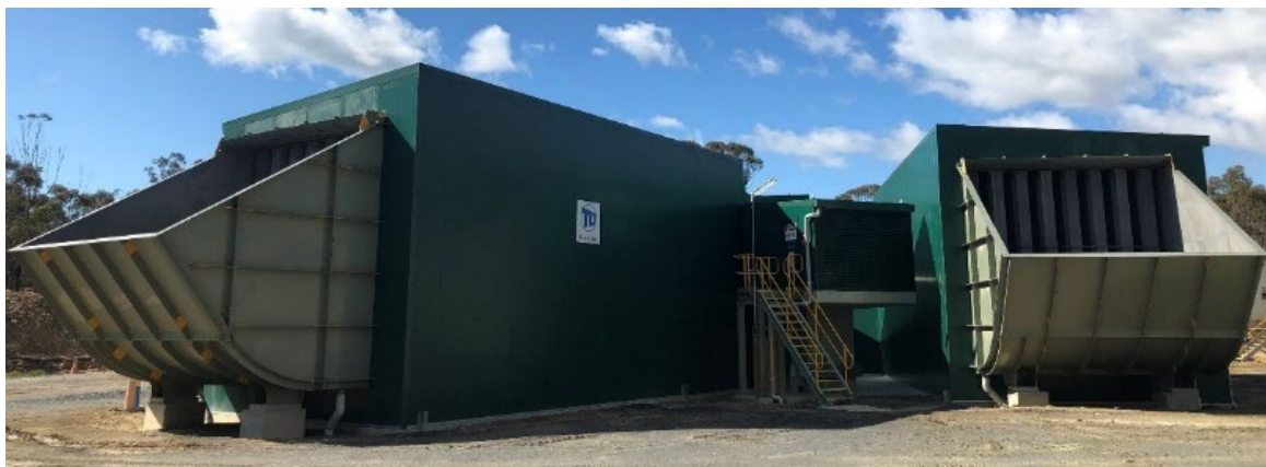
FIG 2 – Surface ventilation fan noise abatement.
